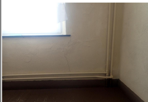
Foto 2: 21: vervorming en/of scheurvorming van gevelvlak of gevelelementen
