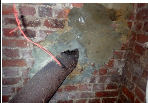
Foto 20: 227: indicatie van een risico op CO-vergiftiging rookgasafvoer verwarmingsinstallatie
