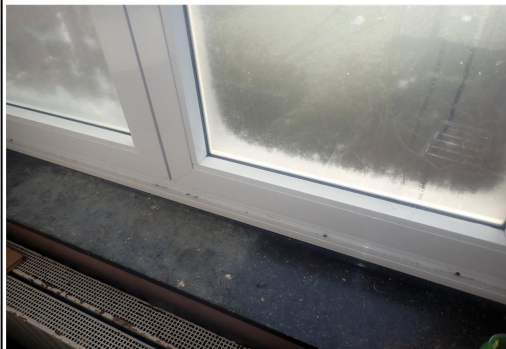
Foto 28: 252: de woning bezit niet de vereiste dubbele beglazing (vanaf 01/01/2020 tot en met 31/12/2022)
