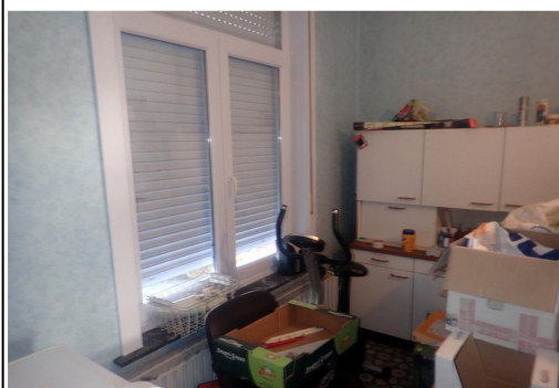
Foto 12: 121: ernstige tekortkomingen (houtrot/corrosie/disfunctie)
