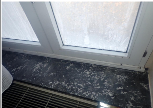
Foto 29: 252: de woning bezit niet de vereiste dubbele beglazing (vanaf 01/01/2020 tot en met 31/12/2022)
