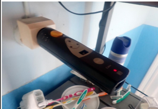
Foto 8: 51: indicatie van een risico op elektrocutie/brand badkamer, aardpen niet aangesloten
