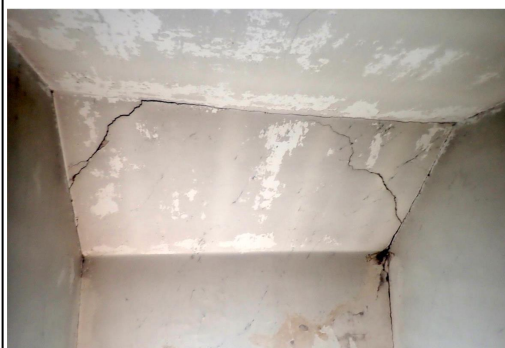
Foto 14: 161: beschadiging (excl. vochtschade) of verwerking / noodzakelijke afwerking ontbreekt
