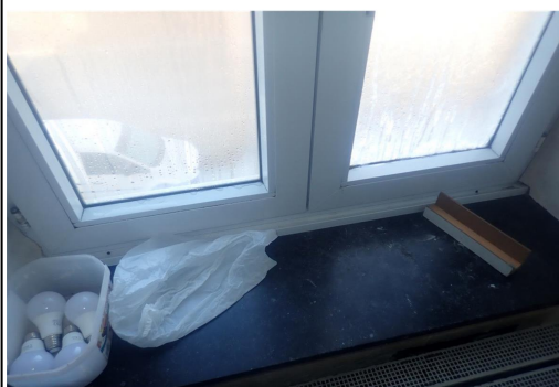
Foto 26: 252: de woning bezit niet de vereiste dubbele beglazing (vanaf 01/01/2020 tot en met 31/12/2022)
