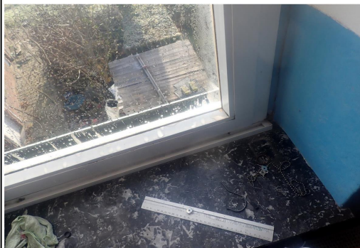
Foto 30: 252: de woning bezit niet de vereiste dubbele beglazing (vanaf 01/01/2020 tot en met 31/12/2022)
