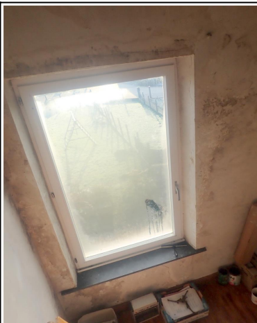
Foto 23: 233: ontbrekende of onvoldoende hoge/stevige borstwering bij lage ramen (vanaf eerste verdieping)
