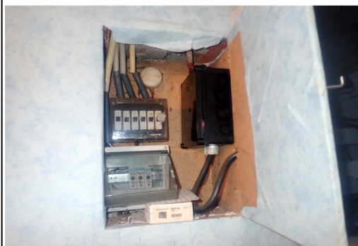
Foto 4: 51: indicatie van een risico op elektrocutie/brand
