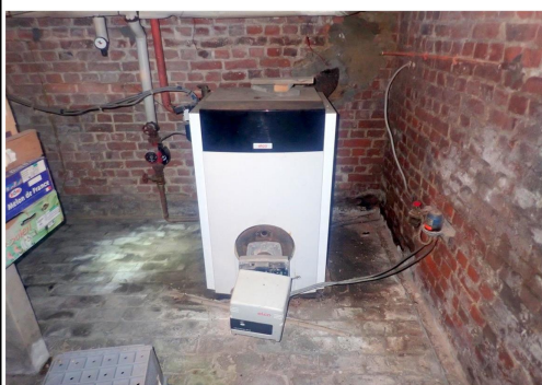
Foto 19: 227: indicatie van een risico op CO-vergiftiging kelder, verwarmingsinstallatie
