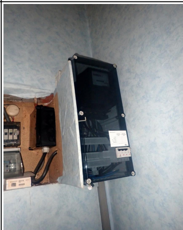
Foto 5: 51: indicatie van een risico op elektrocutie/brand
