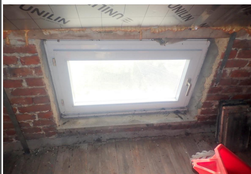
Foto 24: 233: ontbrekende of onvoldoende hoge/stevige borstwering bij lage ramen (vanaf eerste verdieping)
